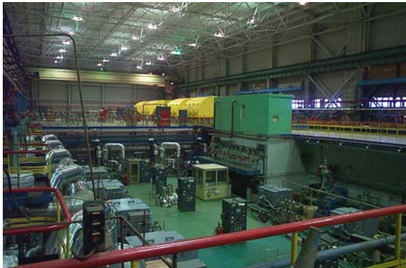
Turbinhallen ved Leningrad kjernekraftverk (Foto: Statens strålevern).
