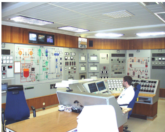
Sikring av kontrollrommet har hatt et hovedfokus i oppgradering av fysisk sikring ved IFEs anlegg (foto: Statens strålevern).
